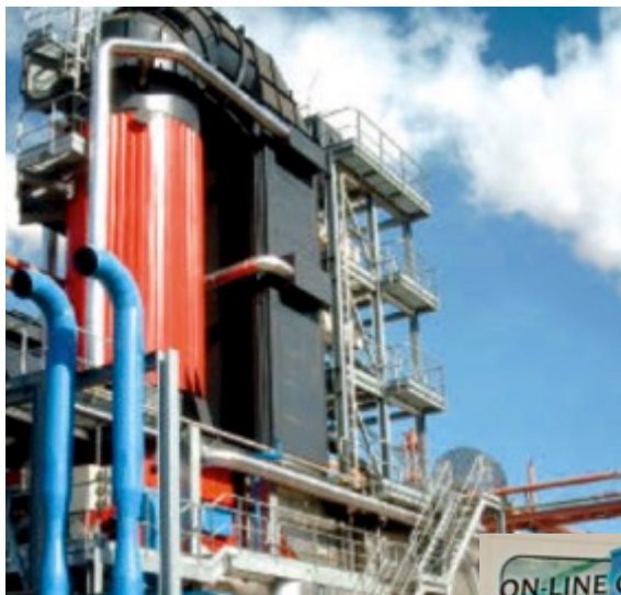
Impianto energetico da biomassa
