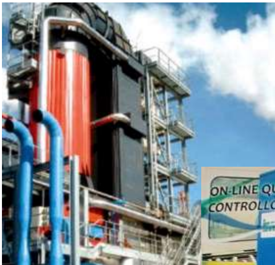
Impianto energetico da biomassa
